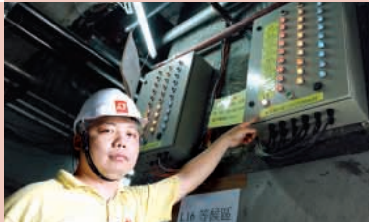
於建築工地內裝置消防警報系統，有效保障地盤運作順暢。
