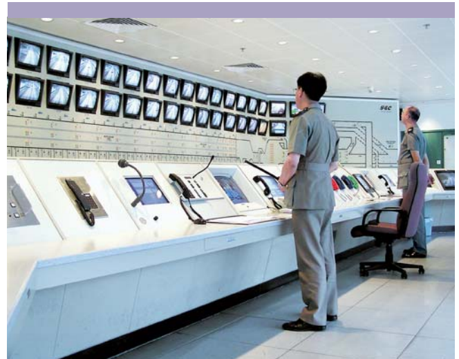
三號幹線(郊野公園段)配備精密儀器確保道路行車暢順。
